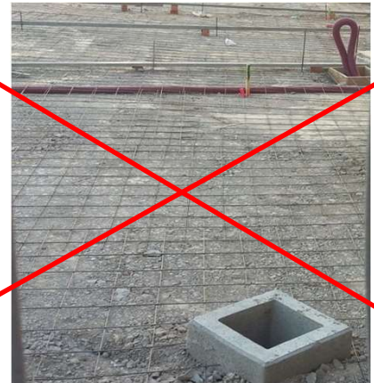
MALLA INUTIL APOYADA EN EL SUELO
