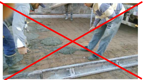
MALA PRÁCTICA, MALLA MAL COLOCADA
