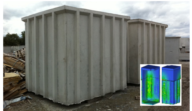
Tanques de transferencia de agua: Se eliminó la cubierta de concreto originalmente especificada para proteger el refuerzo de barras de acero contra la corrosión.
