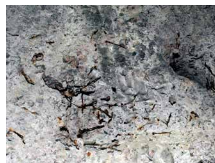
Corrosión in situ del refuerzo de acero
